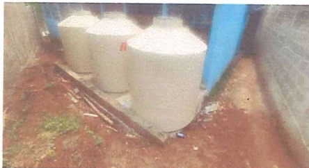
Foto 11: TINACOS PARA CAPTACION DE AGUA
